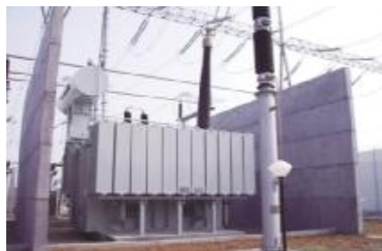
图 3 运行于江陵换流站的 500 kV MCSR
